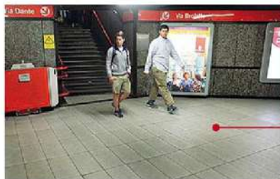
La fermata di Cordusio sul M1: il pavimento del mezzanino, quando piove, diventa molto sdrucciolevole (Fotogramma)
